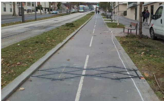
Boucle installée sur la piste cyclable le long de la RD 906 à Châtillon
