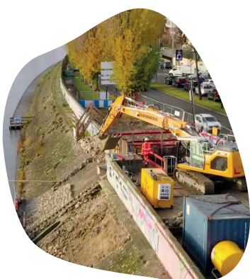
Automatisation d'un déversoir d'orage (Asnières-sur-Seine)
