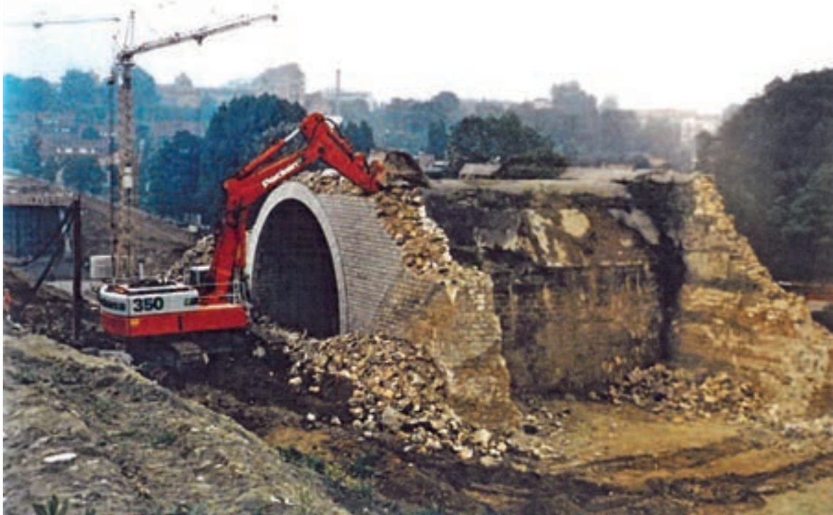
Destruction du pont de Châtenay (juin 1987). Photo Triquet. Extrait de l'étude GRAHAL. Source Musée de l'Ile de France.
