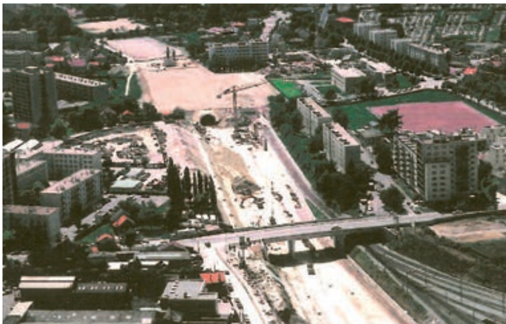
Entrée Nord du tunnel de Fontenay (1er juillet 1987). (Extrait étude GRAHAL, cliché SNCF/CAV n° 35714).
