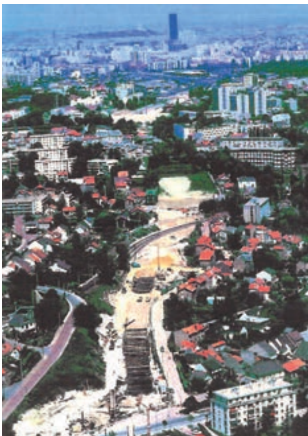
Entrée sud des tunnels de Fontenay (recouvert) et Sceaux (1 juillet 1987) ; (extrait étude GRAHAL, cliché SNCF/CAV n° 35715).
